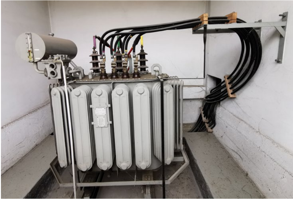
Das spannungsgeladene Herz: der ölgefüllte Trafo
