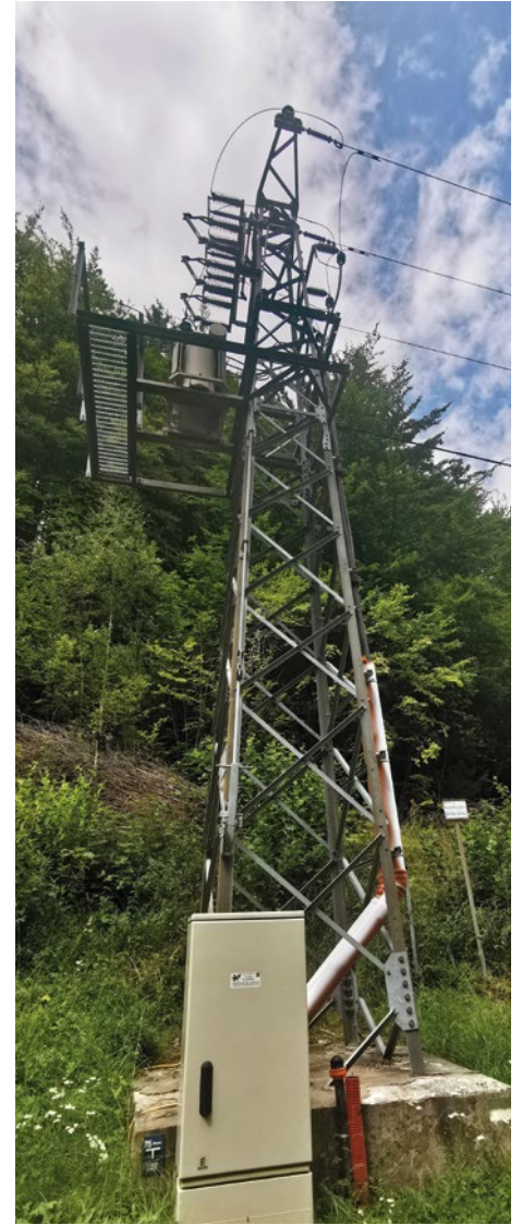
Masttransformatoren – wie hier bei der Almbrücke – ersetzen zunehmend die Häuschen
